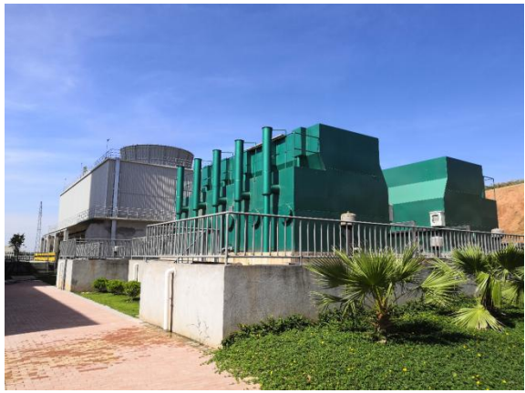
工业废水处理站
